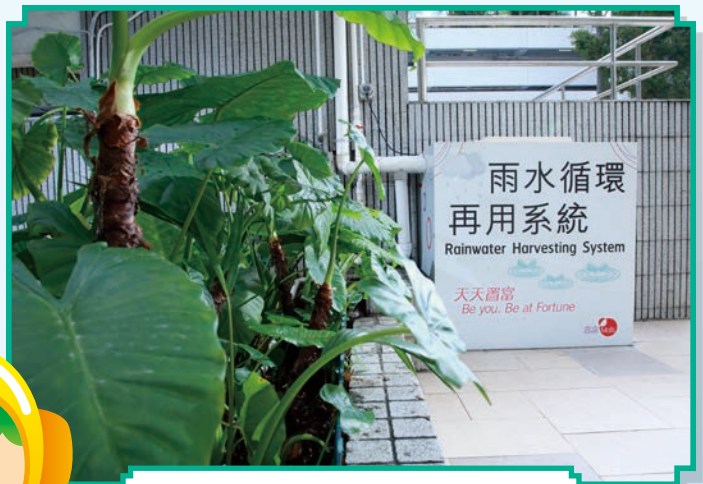
置富第一城的雨水循環再用系統
