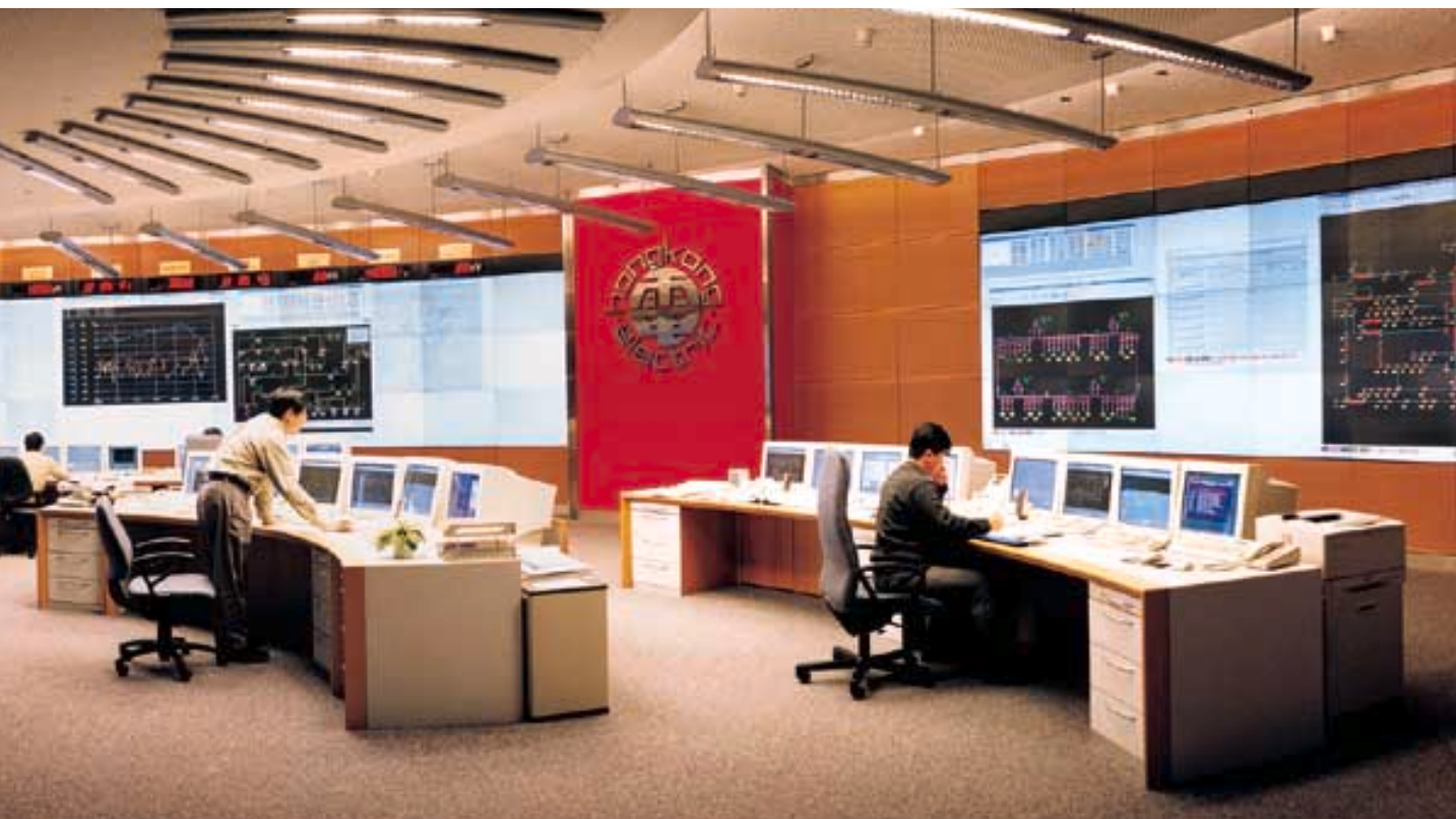
港燈集團的新控制中心是供電系統的樞紐。
