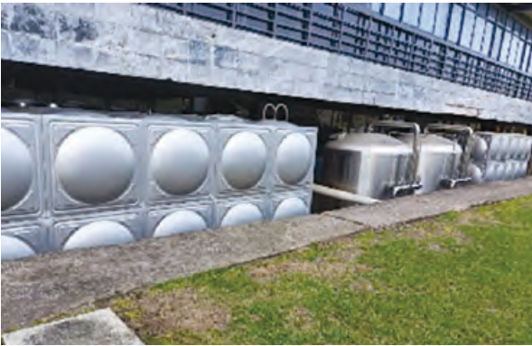
包裝洗瓶水循環設備
