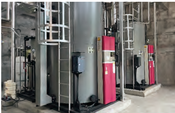
低氮氧化物燃燒鍋爐
