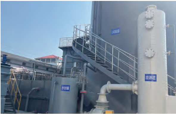
廢水處理設施
