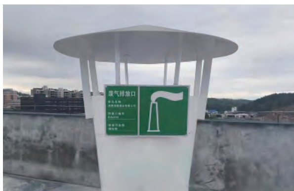
廢氣處理設施
