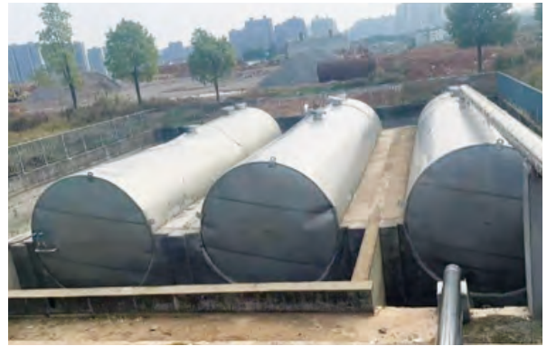
冷凝水回收設備
