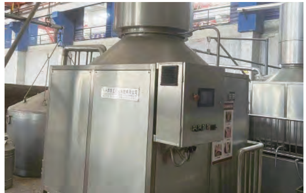
以風冷系統代替水冷系統
