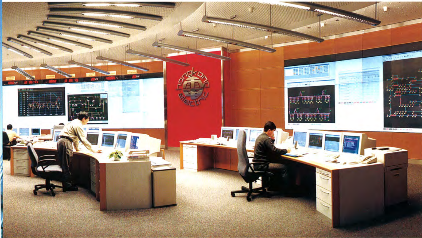
港燈集團的新控制中心是供電系統的樞紐。
