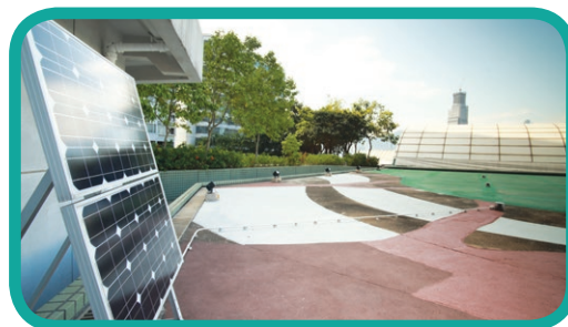
屋頂太陽能電池板
