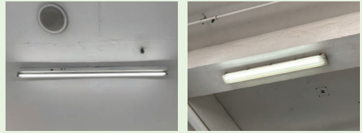
青衣物業走廊及停車場的LED照明裝置
