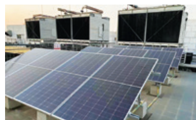
亞信科技大廈頂樓光伏設施
