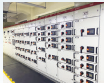
亞信大廈改造後配電室
