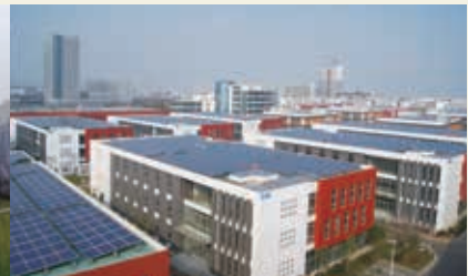
Zhenjiang Rooftop Solar Photovoltaic Energy Project 鎮江屋頂太陽能光伏發電項目
