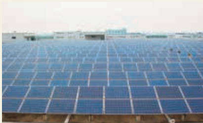
Changzhou Rooftop Solar Photovoltaic Energy Project 常州屋頂太陽能光伏發電項目
