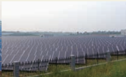
Huaining Ground Solar Photovoltaic Energy Project 懷寧地面太陽能光伏發電項目
