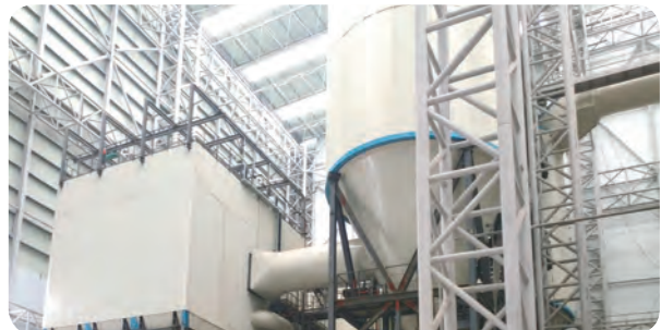
Flue gas purification system 成套煙氣淨化系統
