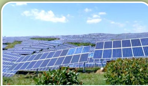
Rizhao City's Photovoltaic Project 日照市光伏項目
