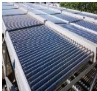
太阳能供热系统
