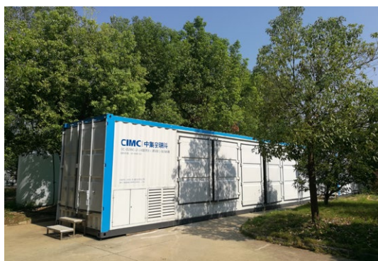
集箱式垃圾滲濾液處理裝置
