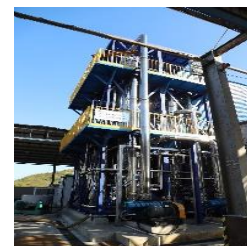
工业废水处理装置
