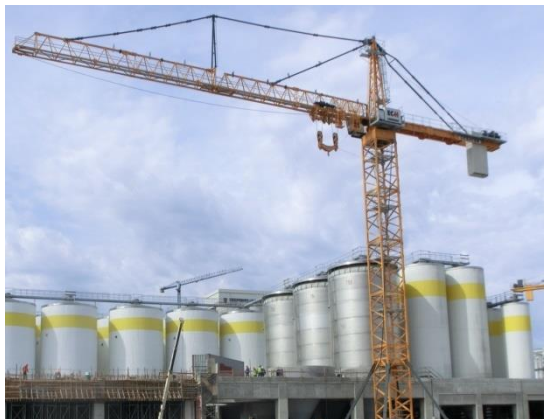
大型啤酒厂发酵罐区和糖化、冷区技术、设备、系统及工程服务
