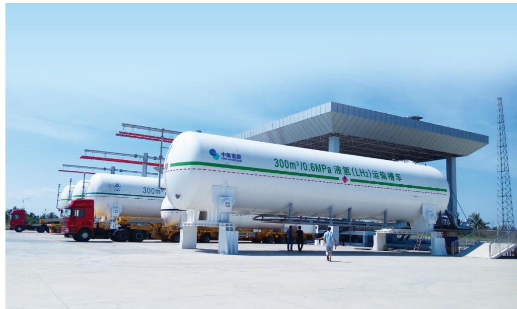
海南文昌卫星发射基地高真空多层缠绕绝热液氢储罐 容积: 300m 3 工作压力: 0.6MPa
