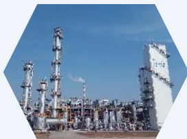
▲ 液化工厂/井口撬装设备 ▲ 陆上井口气处理与加工
