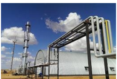
井口气回收装置
