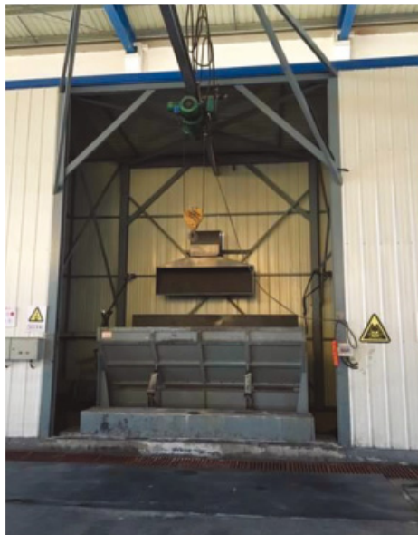
預處理進料口
