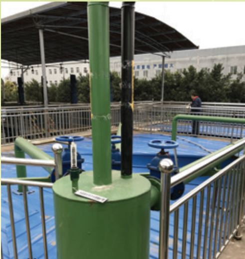
重慶康樂製藥有限公司處理廢棄物設施 — 水解池 Waste disposal facility of Chongqing Kangle Pharmaceutical Ltd. — Hydrolysis tank
