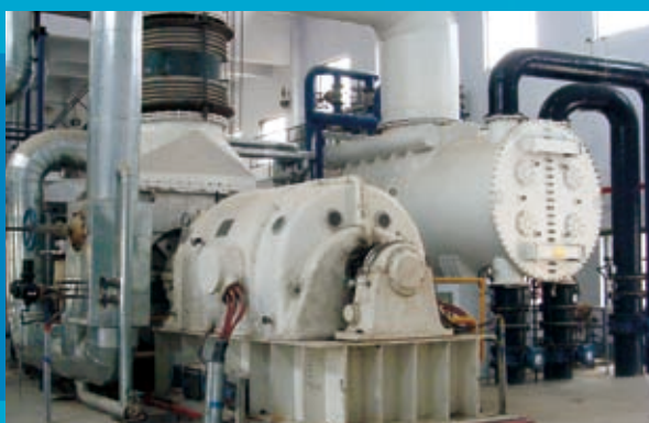
山東聯合王晁水泥有限公司餘熱發電機組 Waste heat power generation set of Shandong Allied Wangchao Cement Limited
