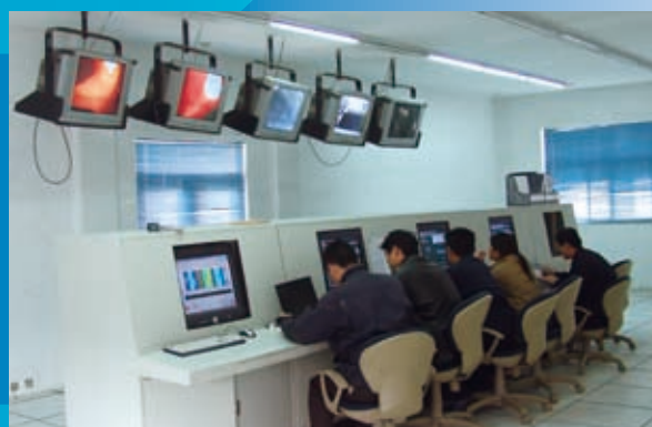
山東聯合王晁水泥有限公司中央控制室 Central control room of Shandong Allied Wangchao Cement Limited
