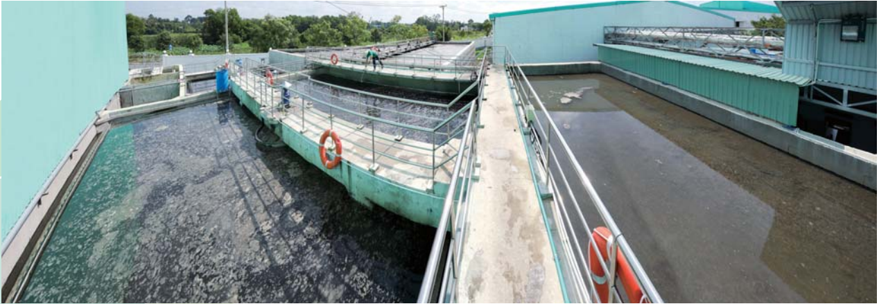
污水處理設施
