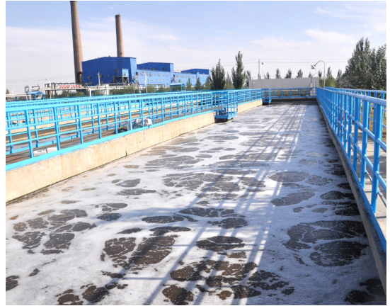
廢水處理設施
