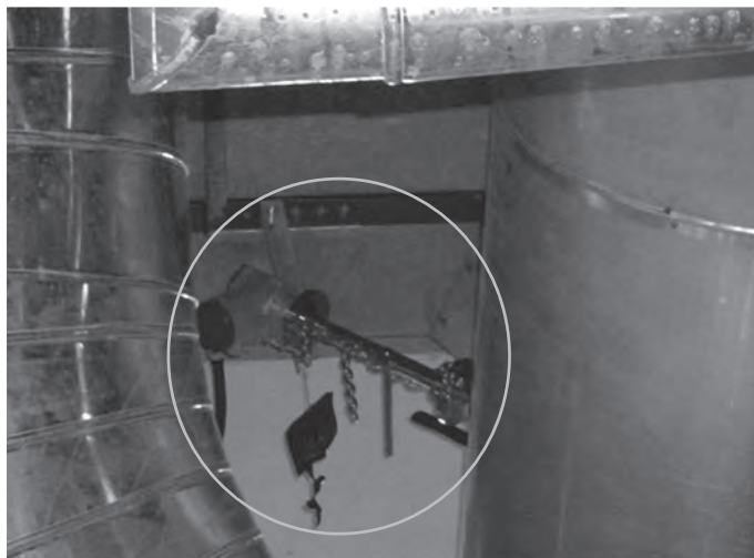
圖16：安裝於一次冷水主供水管之電磁波水流錶
