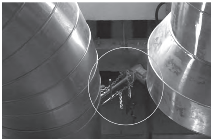
圖17：安裝於二次冷水主回水管之電磁波水流錶
