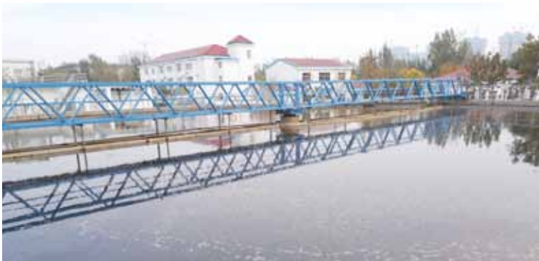
Binzhou Development Zone Waste Water Treatment Project 濱州經濟開發區污水處理項目
