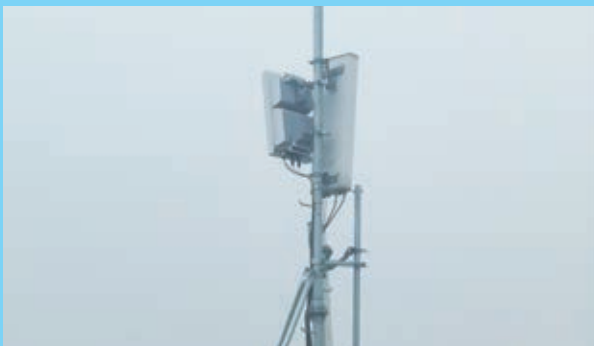
四川省政府樓頂5G設備部署
