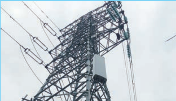
110千伏電力塔掛載通信天線
