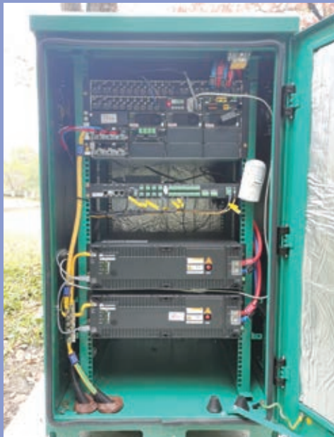
室外一體化電源應用現場
