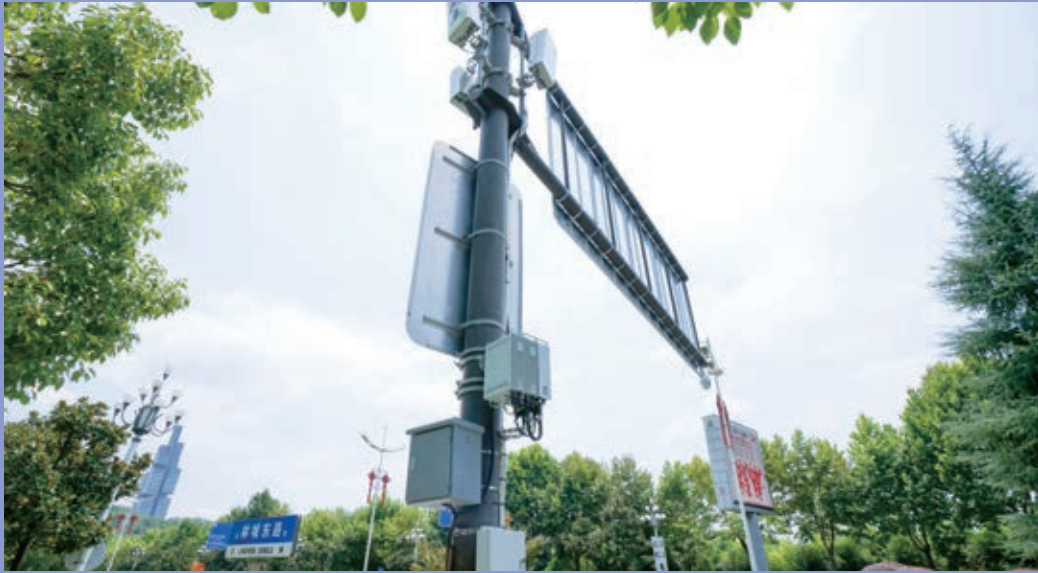
室外一體化電源應用現場
