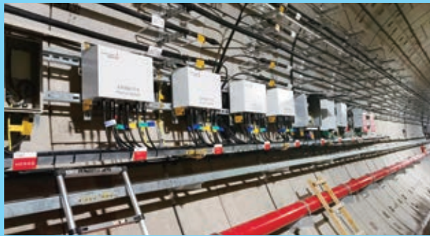
5G共享室分設備
