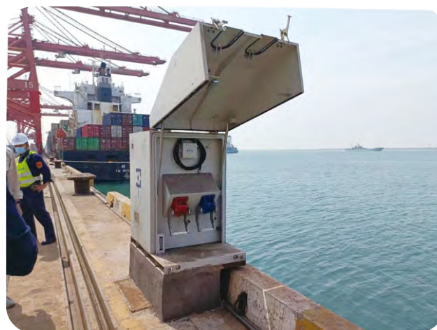
連雲港新東方碼頭已完成兩套5MVA高壓碼頭岸電供電系統及配套岸電插座箱的建設工作，並對五套低壓船舶岸電箱進行升級改造，能適應各類船舶岸電接駁的需要。
