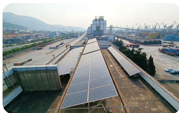
連雲港新東方碼頭已在辦公樓頂安裝分佈式 光伏併網發電系統，裝機容量100kWp， 年發電量11萬度。
