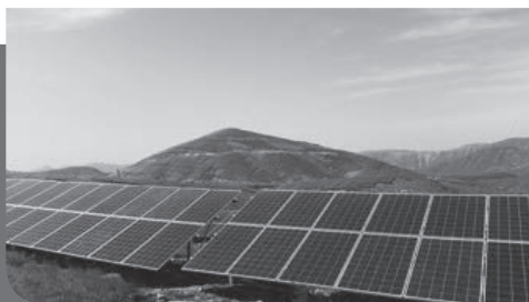
河南省淇縣廟口集中式光伏發電站
