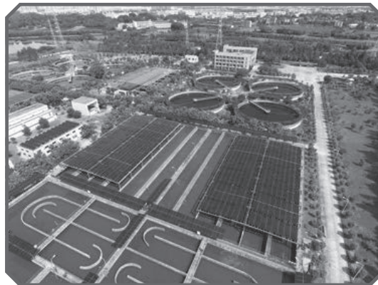
廣東省東莞北控水務集團水廠內的分佈式光伏發電站
