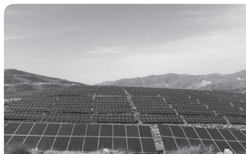
河南省淇縣廟口集中式光伏發電站
