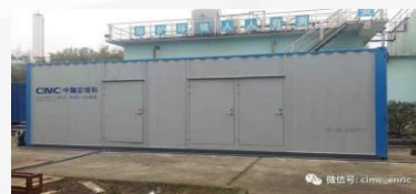
左图：撬装化垃圾渗滤液处理装置
