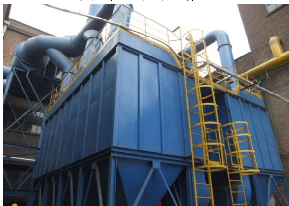
新安装电炉除尘器
