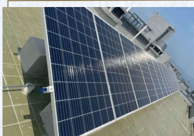
光伏發電系統
