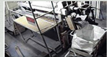
漆渣處理系統
