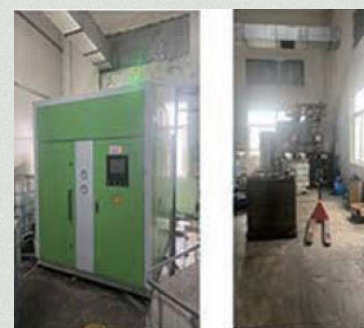
油水分離設施
