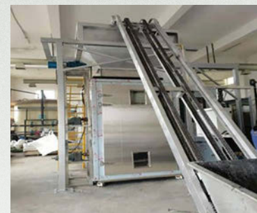
污泥乾化設備
