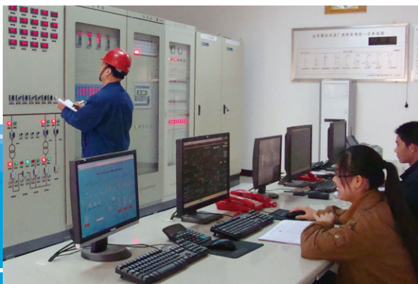
山東聯合王晁水泥有限公司餘熱發電控制室 Control room for waste heat power generation of Shandong Allied Wangchao Cement Limited
