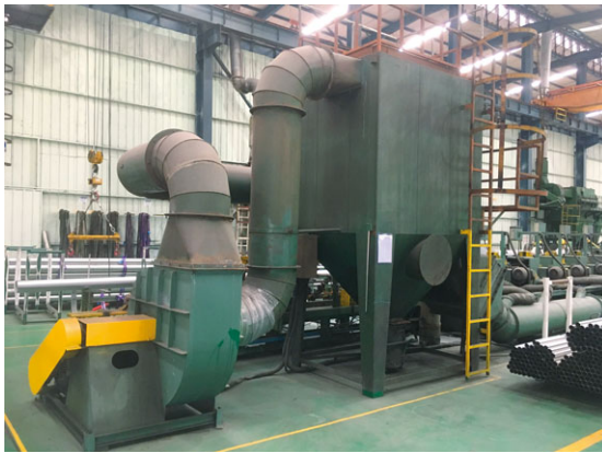
生產廠房中設有脈衝式濾袋集塵機
