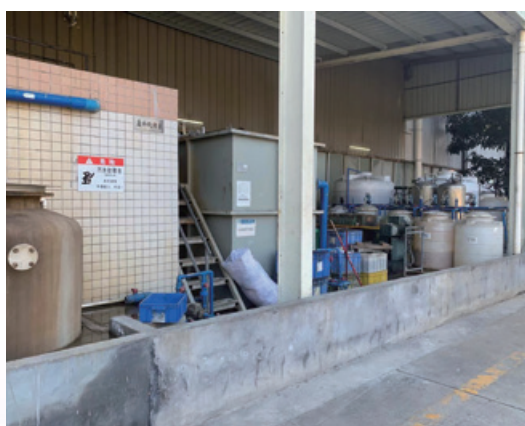
Sewage treatment system 污水處理系統
